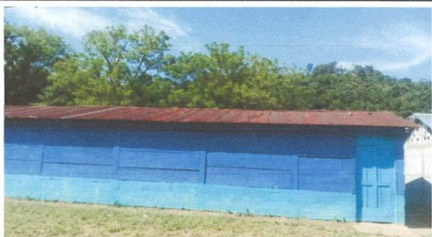
Foto2: MEJORAMIENTO DE AULA TIPO PORTICO- La infraestructura no presenta buena ventilacion ni iluminacion
