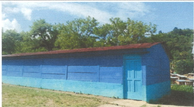
Foto1: MEJORAMIENTO DE AULA TIPO PORTICO- La infraestructura esta dañada por el tiempo y afectada por termitas
