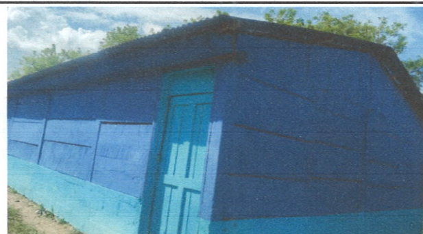
Foto3: MEJORAMIENTO DE AULA TIPO PORTICO- La seguridad se ve afectada por la condicion de la puerta ya que esta ya esta debil y se mueve mucho
